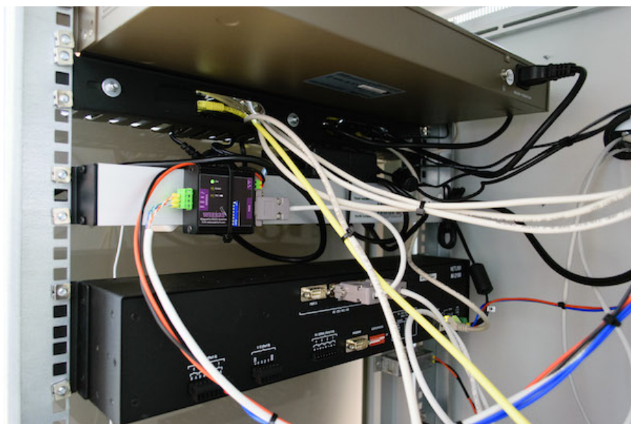
Obrázek 93 – Zapojení uvnitř datového rozvaděče (racku)
